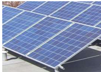
400 kW PV plant in Casino-Ciudad Real Castilla - La Mancha HARRAHS
